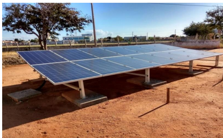
Figura 9 – Módulos fotovoltaicos do SFCR do CITED
