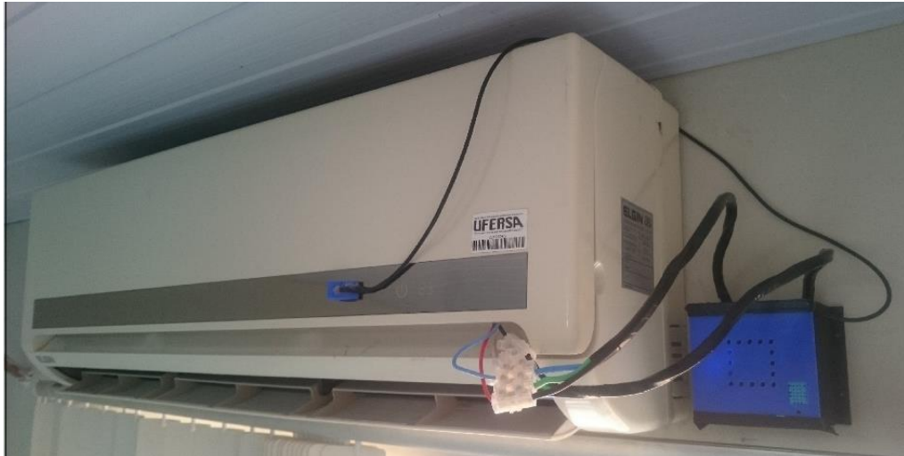
Figura 38 – Protótipo instalado no condicionador de ar da UFERSA. Fonte: Autoria própria.
