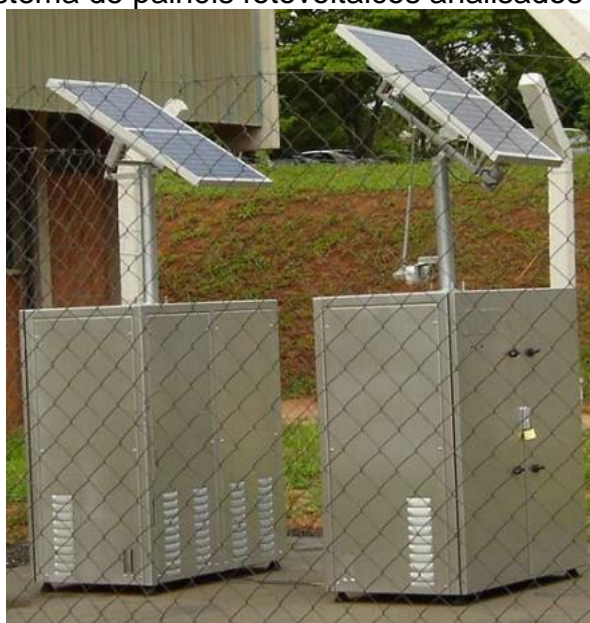
Figura 27 – Sistema de painéis fotovoltaicos analisados em Alves, 2008
